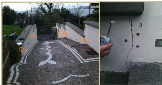
Figura 5 – Caposaldi e comparatore digitale per la valutazione della fessurazione.
